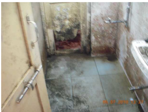
Broken Toilet door
